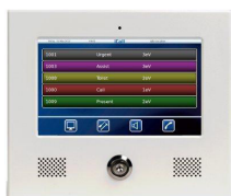
Stazione infermiera touchscreen, luci fuoriporta LED, moduli e pulsanti di chiamata installati
